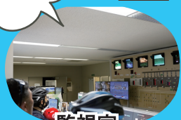
監視室 (管理事務所内)
