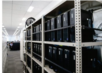
PC設置エリア 2か所目 オフィスの一画（冷却対策あり）
