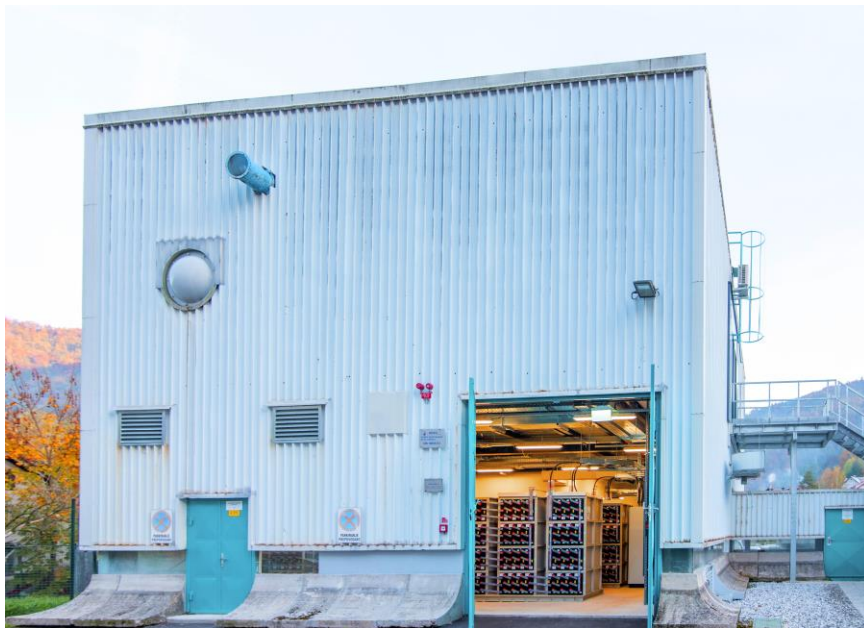
図1 実証運転を開始した、イドリア市内の配電系統に設置した蓄電池システム
