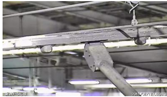
図 - 2 正常なパンタグラフのすり板
