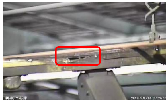
図 - 3 溶損したパンタグラフのすり板
