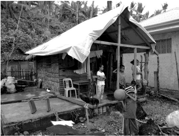
台風で屋根が吹き飛んだ住宅。国連機関から一時的な措置としてシートが配られている。
