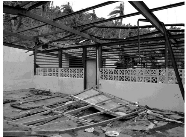
台風で屋根が吹き飛んだ学校。修繕は手つかずの状態である。
