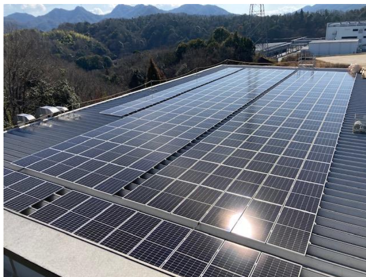
三原工場の太陽光パネル
