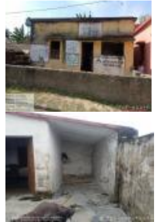
今回プロジェクトを行う幼稚園。 教室や衛生設備、園庭が劣悪な状態
