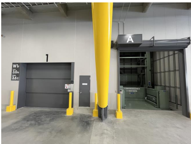
<荷物用EV・垂直搬送機>
