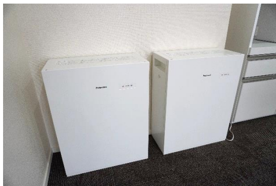
蓄電池は太陽光発電から蓄えられた電力を災害時に活用します
