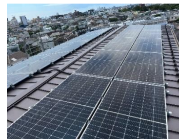
【設置した太陽光パネルの一部】
