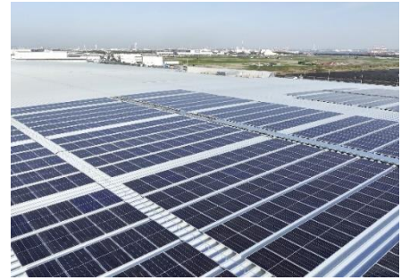
<太陽光パネル>
