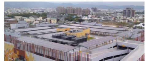
南館屋上の太陽光パネル
