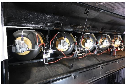
バス上部に搭載されている高圧水素タンク
