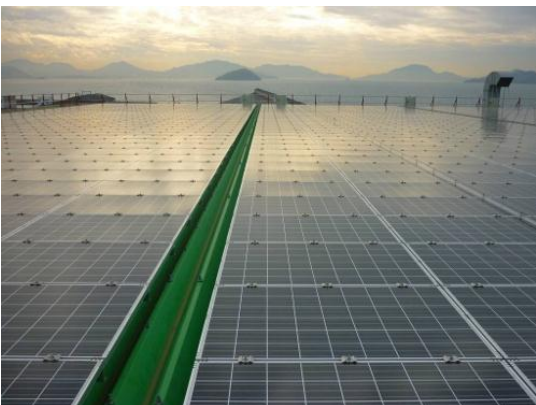
※今治造船株式会社 丸亀事業本部 多度津事業部 (太陽電池容量 : 1,300kW)
