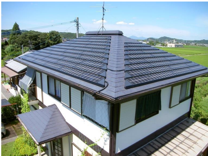
<住宅用太陽光発電システム 5.33kW>
