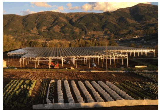
翔栄クリエイトで施工した片野牧場（静岡県田方郡函南町）のアグリソーラー
