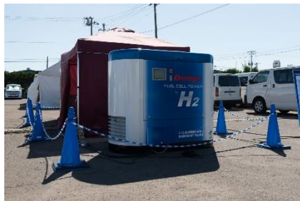
（燃料電池式可搬形発電装置）
