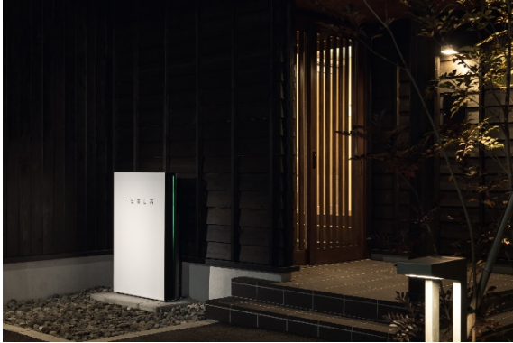
写真1: 「古民家の宿川の音 離れ」へ設置されたPowerwall
