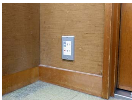
寺務所に設置したプレトラックコンセント
