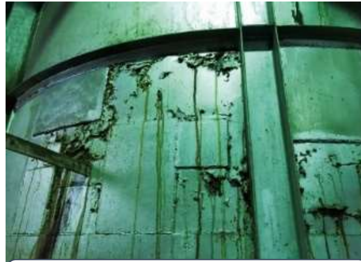
塗装が傷み、錆が流れる焼却炉
