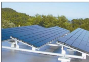
太陽光発電設備
