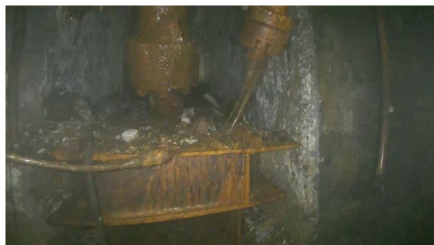
CRD 交換用開口部付近の様子(ペDESTAL内から撮影)
