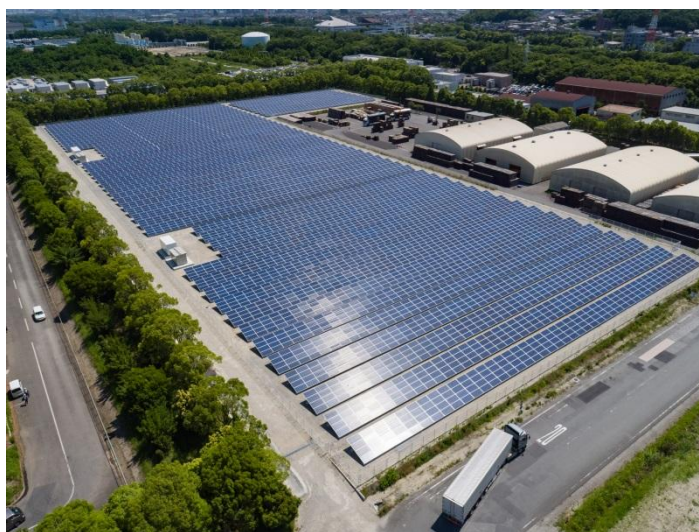
LIXIL 知多 SOLAR POWER (5.2MW)
