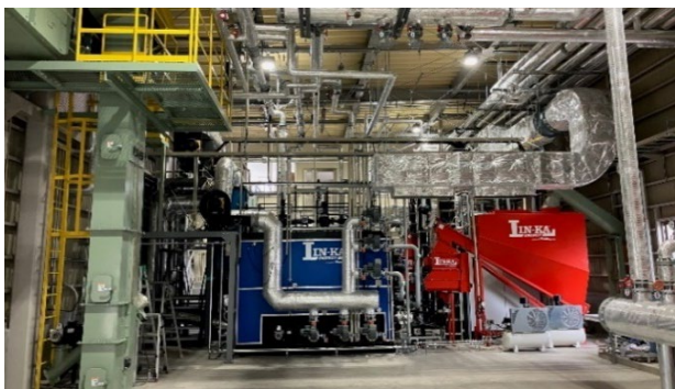
ボイラー棟内
