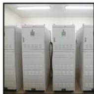
リチウムイオン蓄電池
