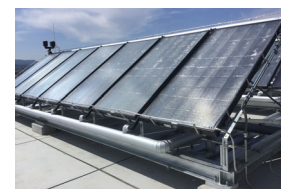
【太陽熱集熱パネル】
