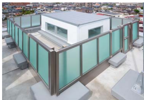
「自動制御換気塔」
