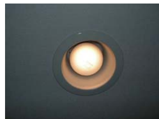
非常用LED照明
