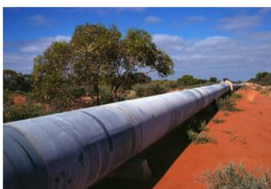
パイプライン
