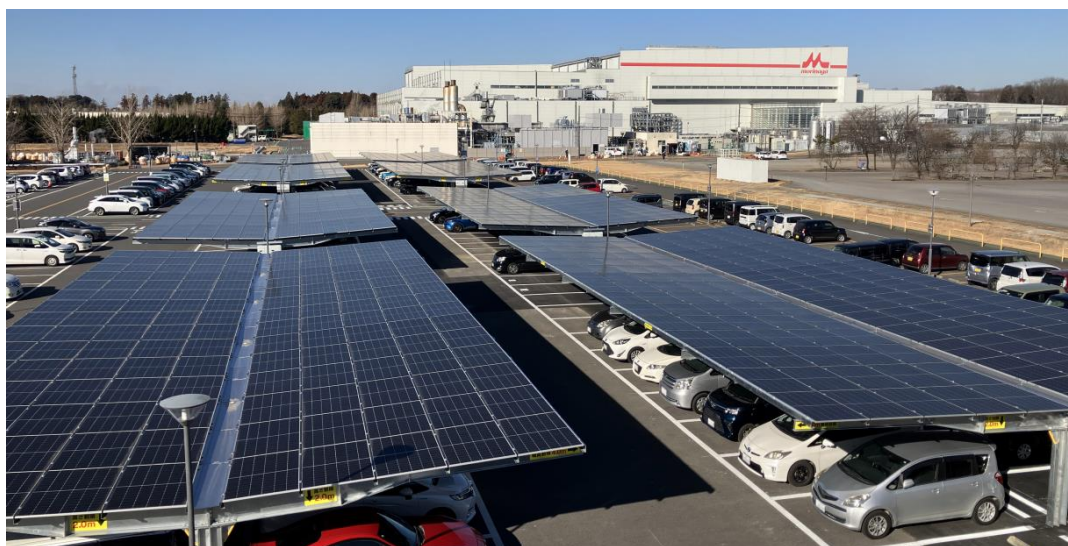
利根工場駐車場に設置したカーポート型太陽光発電設備
