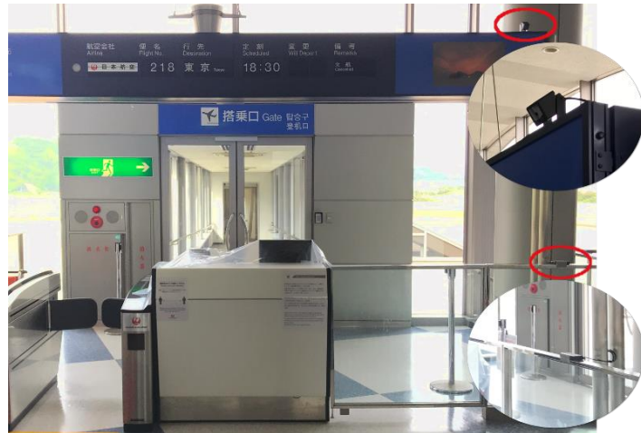
設置イメージ：掲示板右上→人感センサー 手すり→環境センサー（二酸化炭素濃度、音）
