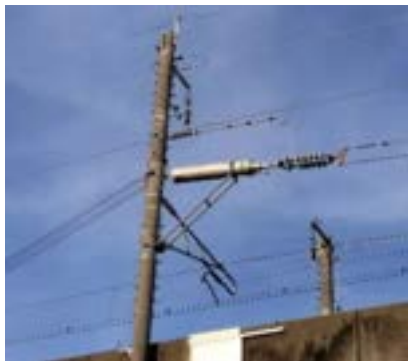
新幹線電車線（架線）設備
