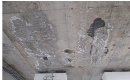
床版下面の損傷状況
