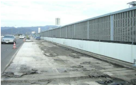
床版上面の損傷状況
