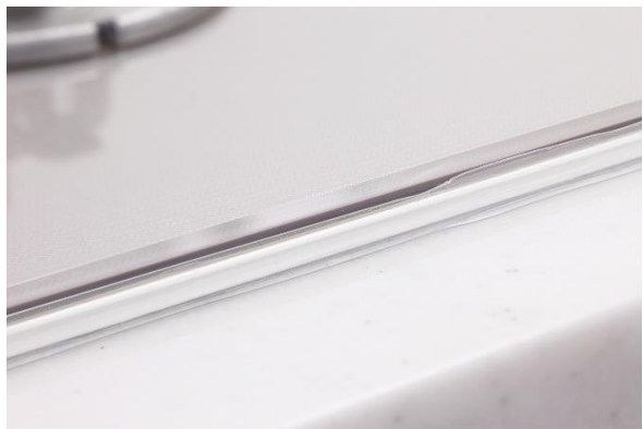
テープを貼った状態のコンロ周辺のすきま
