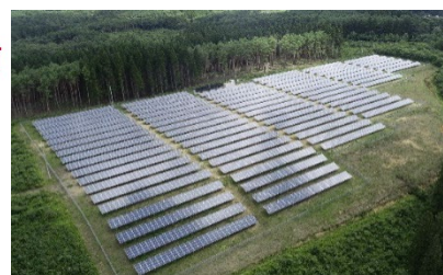
種市電工株式会社 洋野町種市メガソーラー発電所
