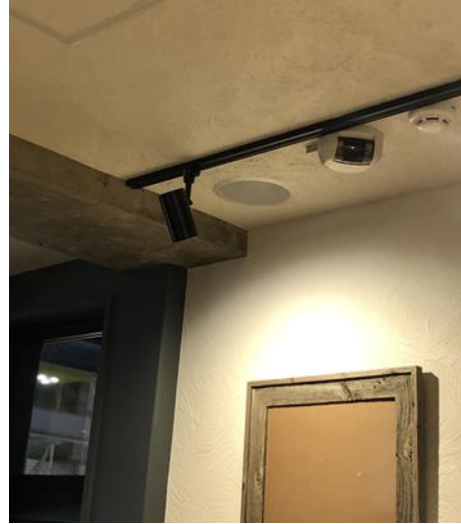
【天井に埋め込まれた ICS-20】
