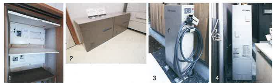
1.2台の配電盤のうち、上が系統との接続用。上のブレーカーを落とすと太陽光・蓄電池の電力のみになる 2.蓄電池の容量は14.9kW。むやみに容量を増やしても自立度が高まるわけではない 3.将来を見据えV2Hも設置 4.給湯器は「熱を熱のまま利用する」ため太陽熱併用型エコキュートを使用
