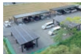
伊根町役場横の 太陽光発電設備
