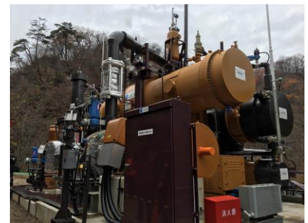
土湯温泉 16 号源泉バイナリー発電所
