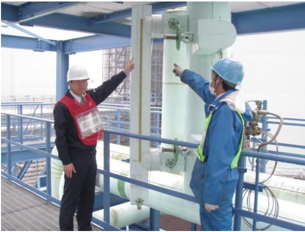
移送配管満液確認
