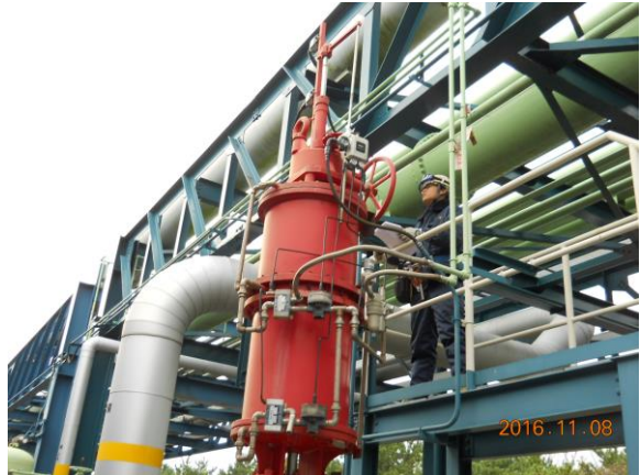
基地間の境界弁確認
