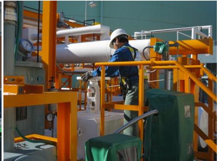
ポンプ起動直後の機器確認
