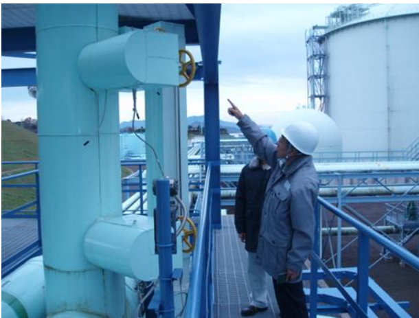
受払配管の満液確認
