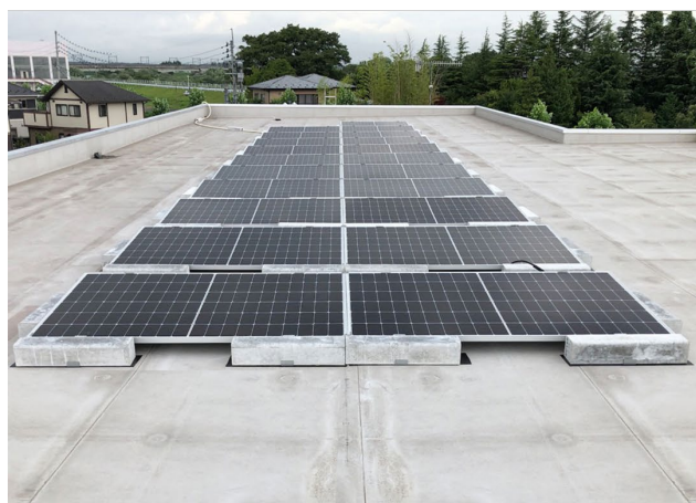
（設置した太陽光発電設備/古川くりの木保育園）
