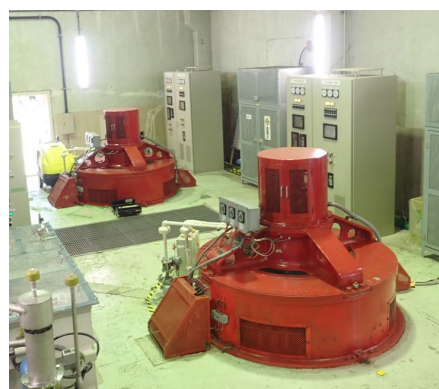
発電所内部（発電設備）
