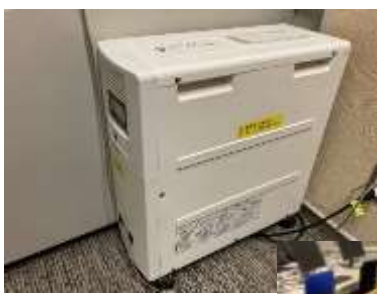
◀ 停電時に最低1週間はPCなどの稼働が可能なように蓄電池を配置
