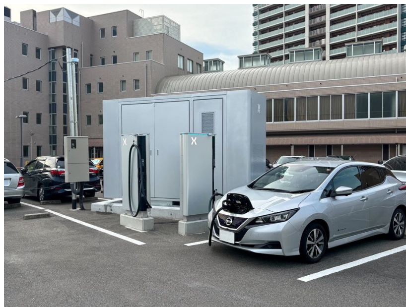
画像：設置されたパワーエックス製蓄電池型超急速 EV 充電器
