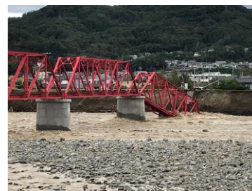
▲崩落した別所線鉄橋
