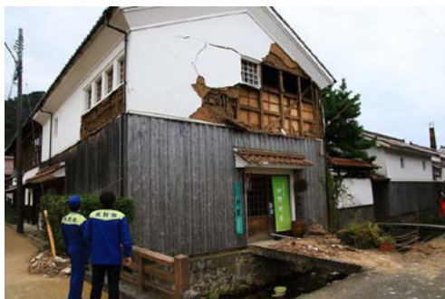
発生当時の白壁土蔵群の建物被害
